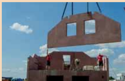
Třetí den je věnován montáži stěn 2. NP, následuje zašalování svislých a vodorovných spár a zabetonování
