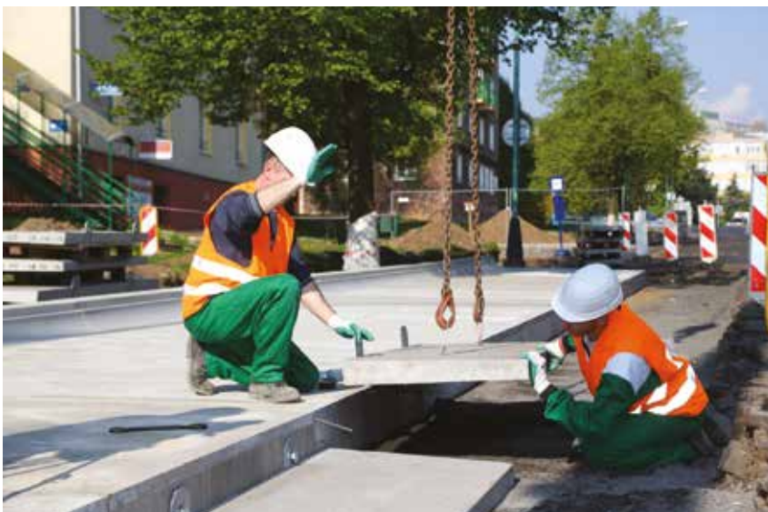
Montáž končí zasazením tzv. přechodových panelů, které řeší problém přechodu z tuhé na netuhou konstrukci. Jedná se tak o přechodovou část mezi betonovým panelem a okolní živičnou komunikací
