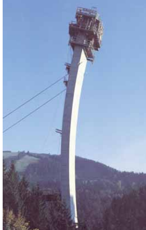
Letmá betonáž poloviny oblouku mostu Argentobel ve svislé poloze, před sklápěním (Vorspann-Technik GmbH)
