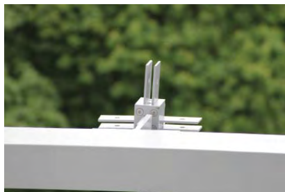
Základní elementy měly průřez velkého T a byly obrobeny s přesností na desetiny milimětru, což při kompletaci a montáži vyloučilo chybovost. Při výrobě byla také nastavena několikastupňová kontrola. Extrémní přesnost se zhodnotila na staveništi, kde do sebe prefabrikáty precizně zapadaly, a ve finále přinášela také časovou úsporu. Foto Sipral
