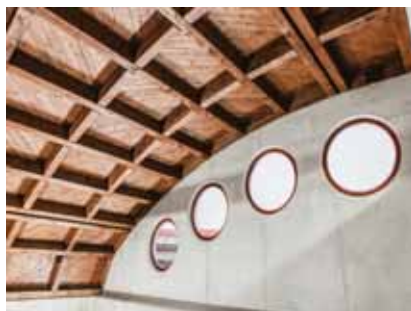
Podhled je dřevěný, odnímatelnou částí střechy lze manipulovat s technologií elektrárny
