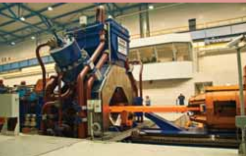
Rychlokovací stroj uvnitř nové haly
